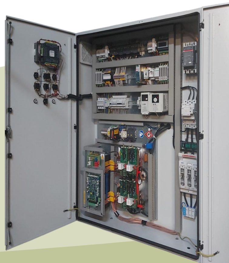
► Generator i Układ Sterowania
